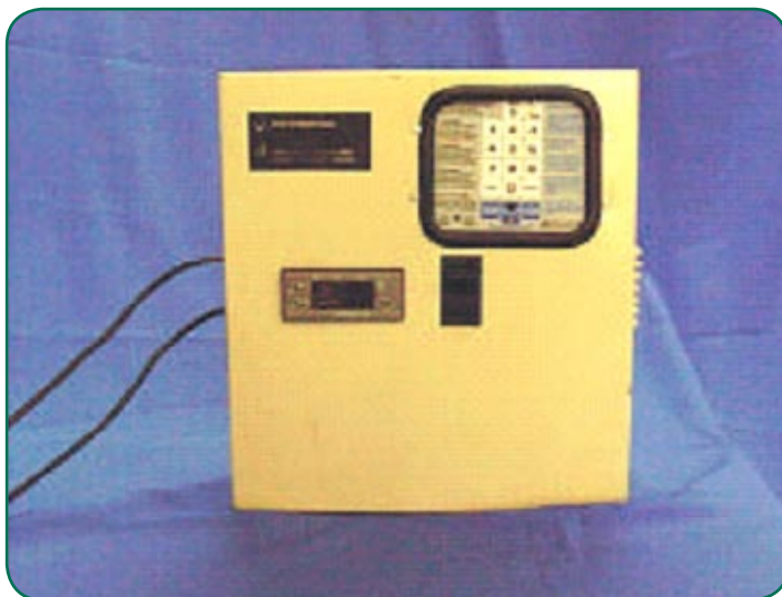
Figura 22. Sistema de alarma con marcador telefónico
